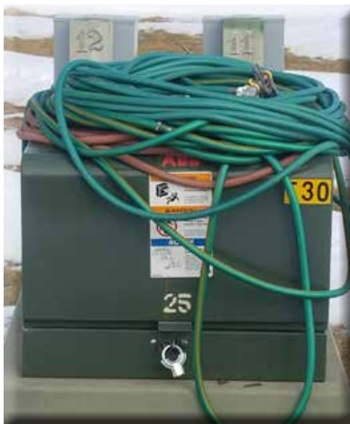
Actual CKPPD customer pad mount transformer.
